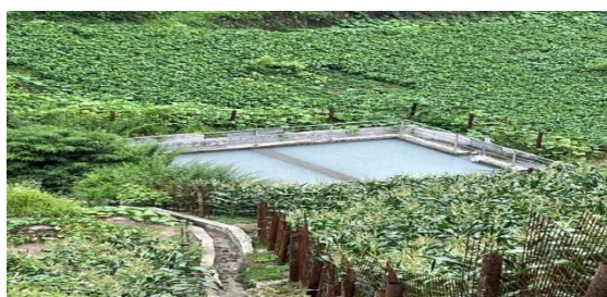
矸石堆场淋溶水沉淀池
