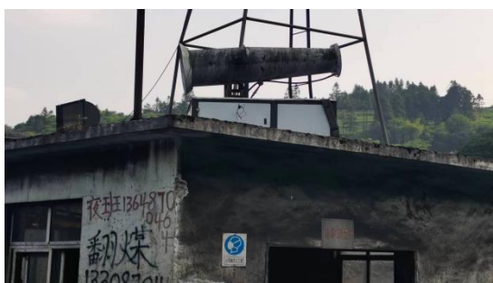
原煤堆场水雾喷淋设施
