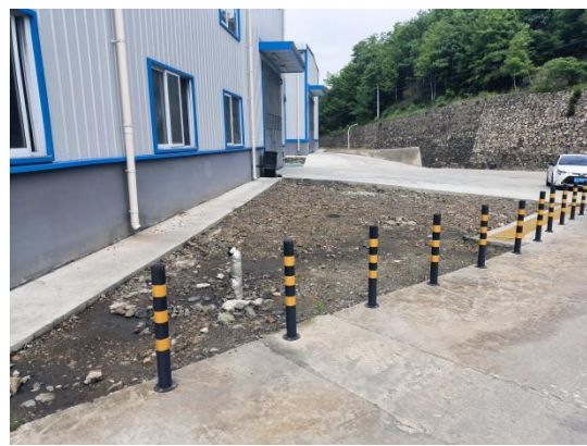
图 3.4-1 裸露地表苫盖不足
