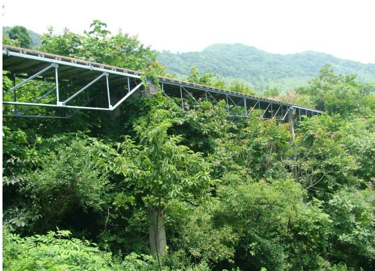
图 3.1-7 尾砂输送管线
