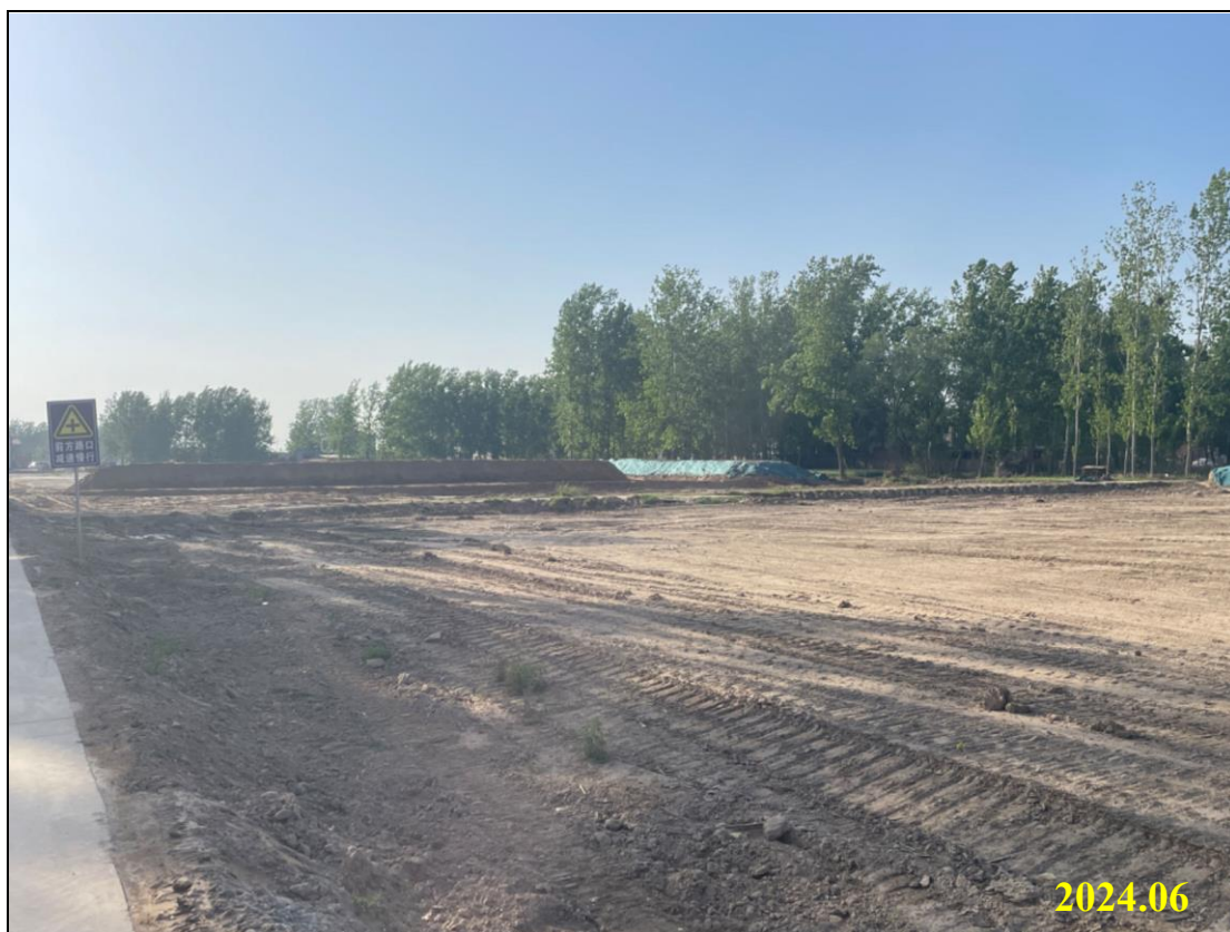
部分临时堆土苫盖不全面
