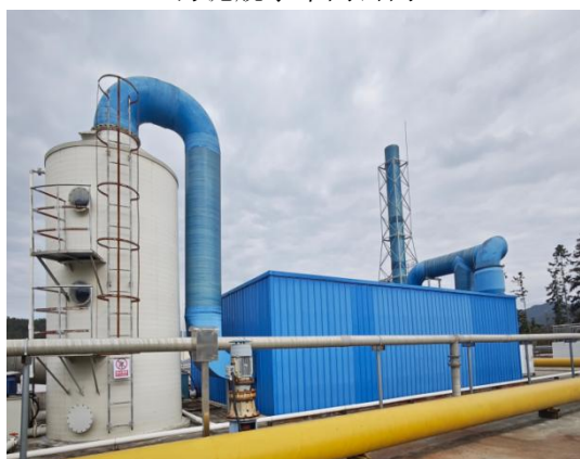
碱液吸收+生物除臭法除臭装置
