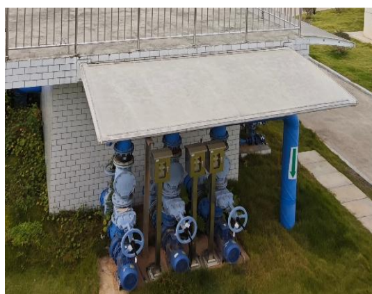
水泵采用潜水泵、湿式安装
