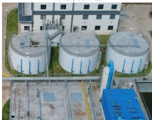
污泥浓缩池加盖
