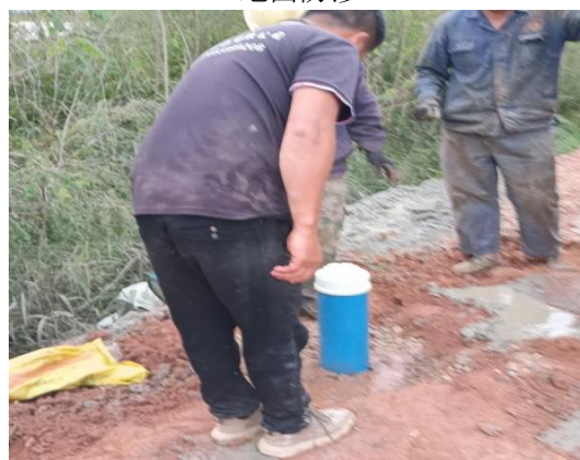
场地下游监控井
