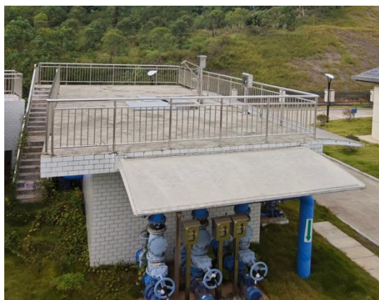
中间提升泵房及污泥泵井
