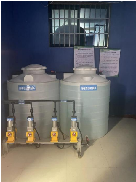
传染病房废水消毒设施
