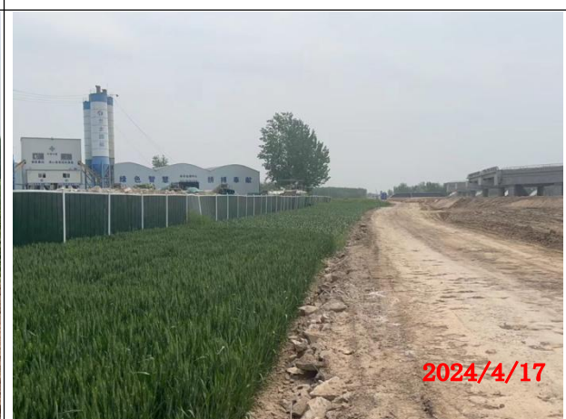
K87+750 施工道路一侧缺少临时排水沟
