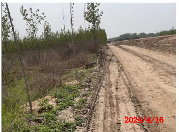
K26+500 施工道路一侧缺少临时排水沟
