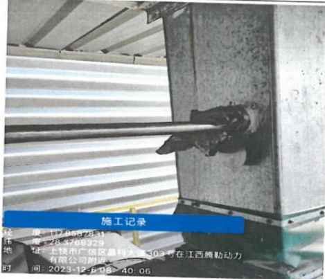
G2 车间废气排放口
