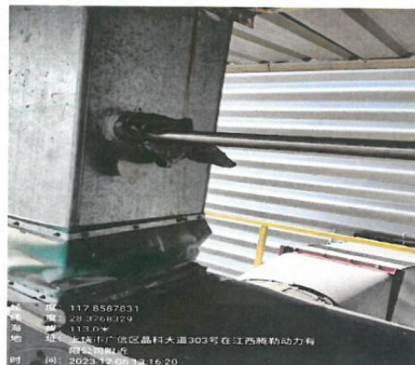
G1 车间废气排放口
