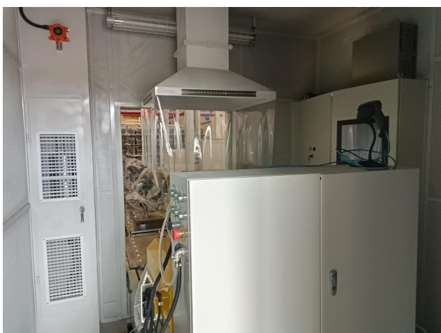
废气收集装置
