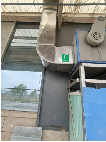
废气排放口标志牌
