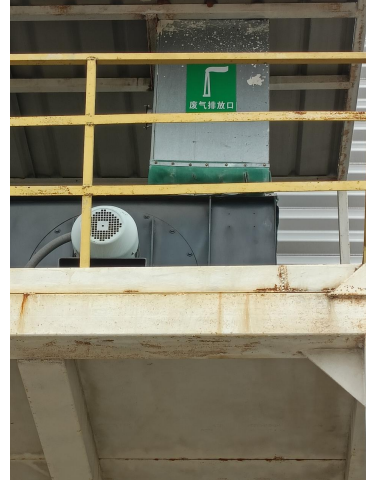
废气排放口标志牌
