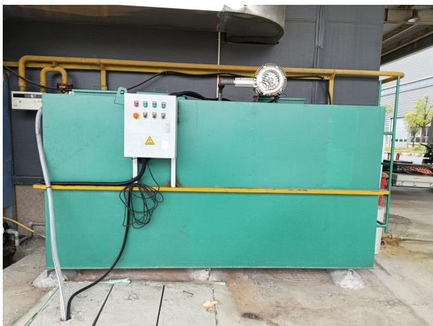
废水处理设施
