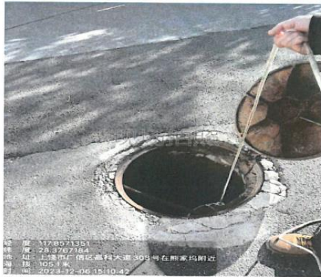
W1 废水排放口
