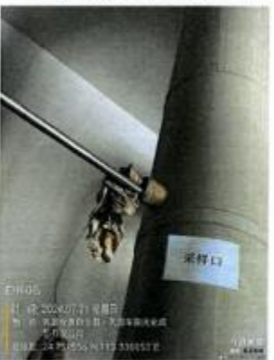
EH60 排气筒处理后 07月21日
