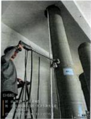
EH58 排气筒处理后 07月18日
