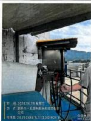
锅炉废气排放口 06月19日
