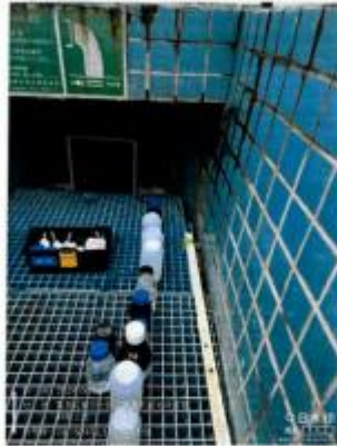
化成箔废水处理后排出口 06月18日
