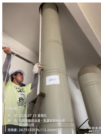
EH59 排气筒处理后 07月19日
