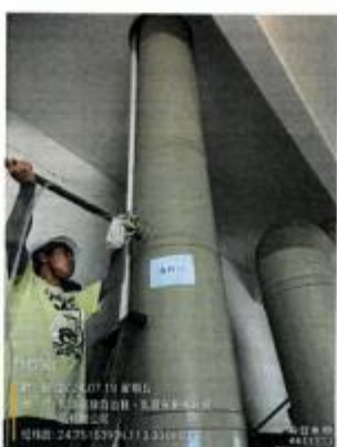
EH59 排气筒处理后 07月19日
