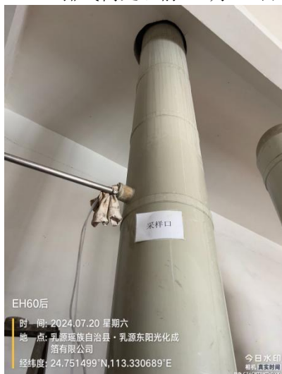
EH60 排气筒处理后 07月20日
