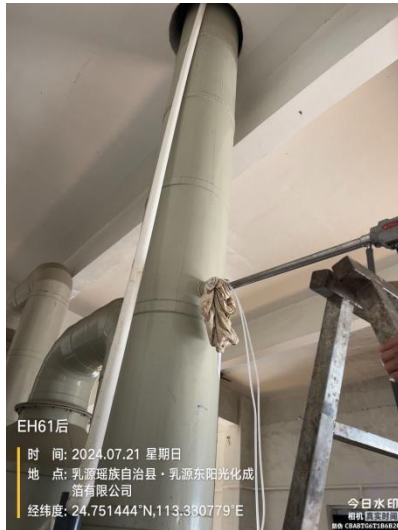
EH61 排气筒处理后 07 月 21 日
