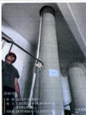
EH61 排气筒处理后 07 月 20 日
