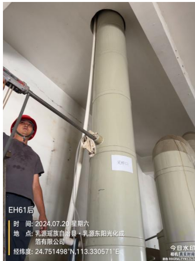
EH61 排气筒处理后 07 月 20 日
