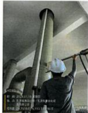
EH59 排气筒处理后 07月18日
