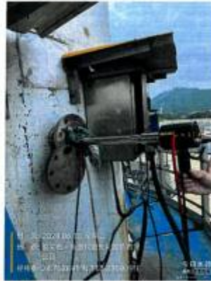
锅炉废气排放口 06月18日
