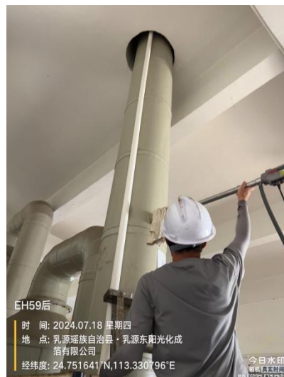
EH59 排气筒处理后 07月18日
