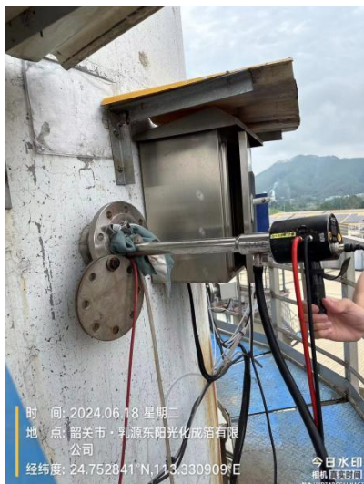
锅炉废气排放口 06月18日
