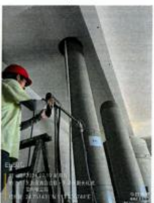
EH58 排气筒处理后 07月19日
