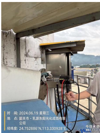
锅炉废气排放口 06月19日
