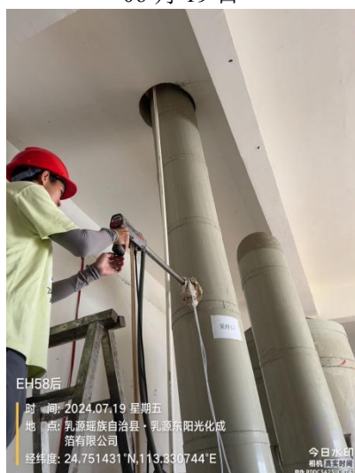
EH58 排气筒处理后 07月19日
