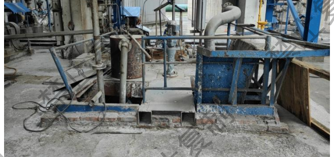
苛化工段废水收集池
