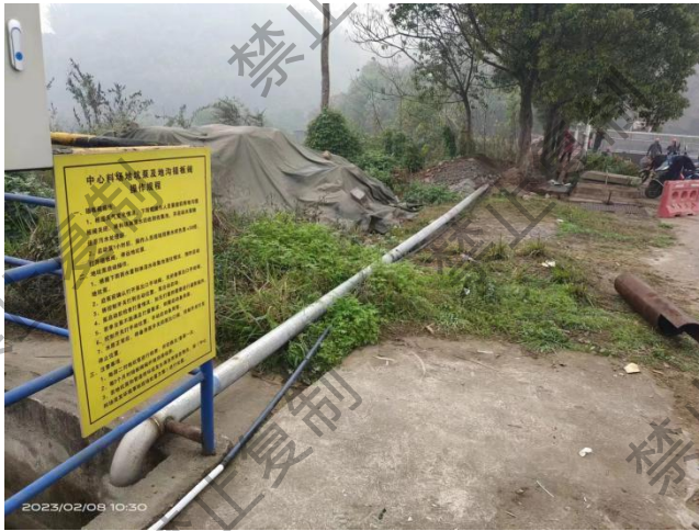
事故池污水连接污水处理系统管道
