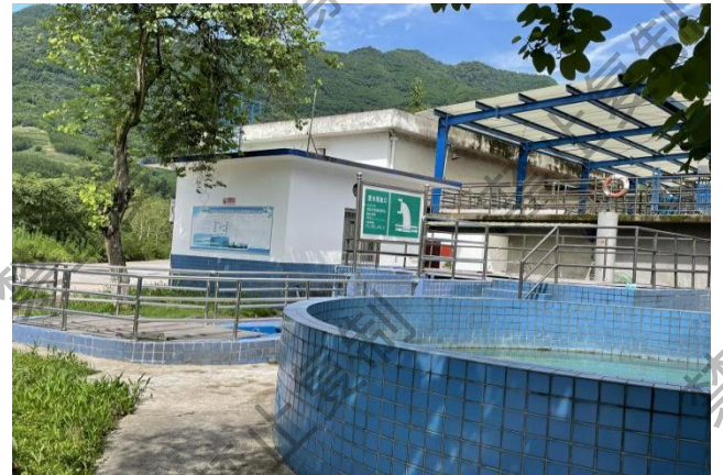
污水处理站排污口
