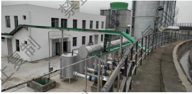
污水处理站芬顿系统
