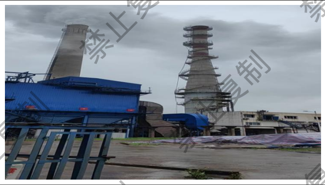
75吨燃煤锅炉烟气脱硫装置
