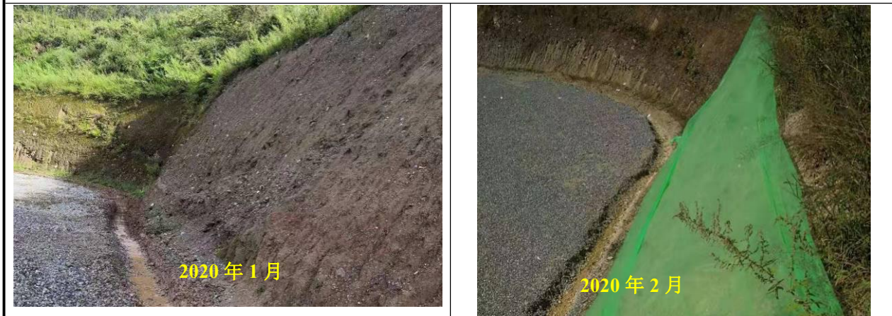
南门景区临时停车场边坡临时排水沟、临时覆盖、撒草绿化
