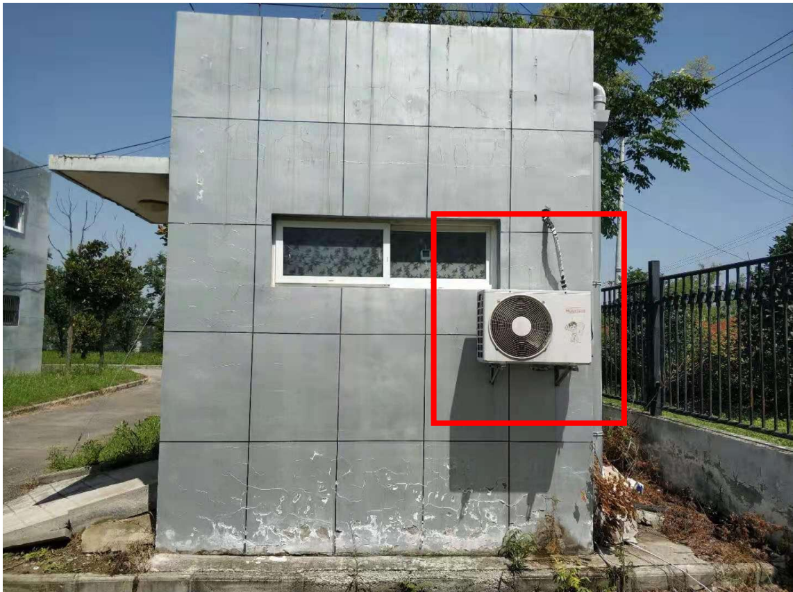
出水在线监控室空调系统
