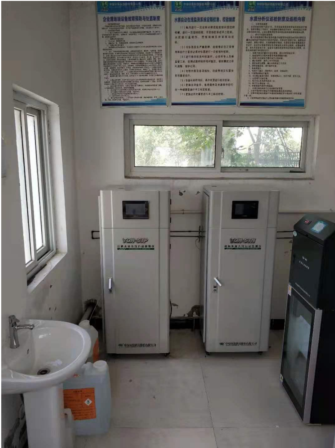
污水处理厂出水口在线监控室内部照片
