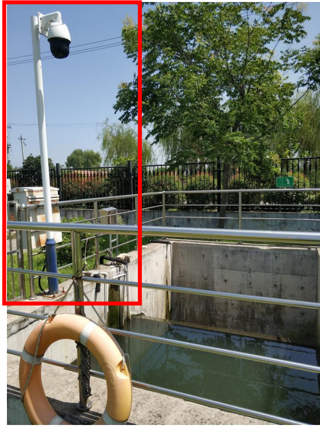
出水口监控设施
