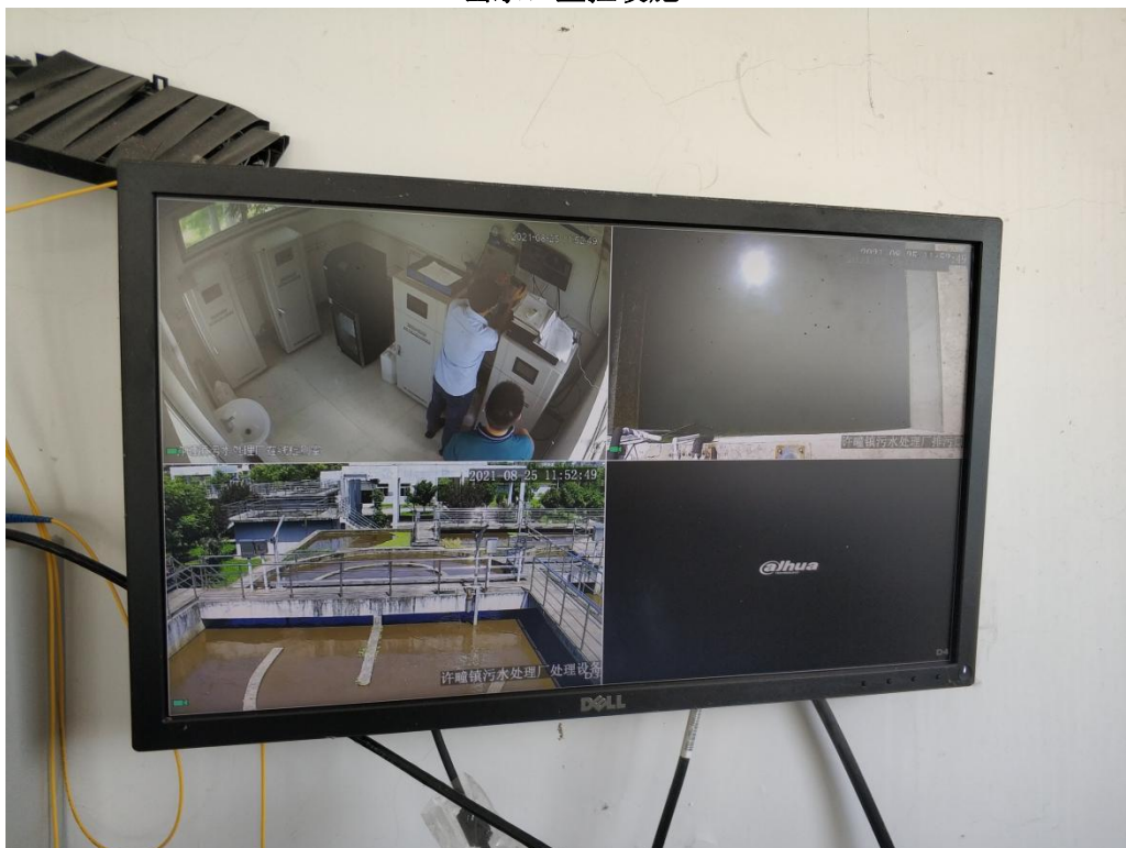
出水在线监控室监控系统
