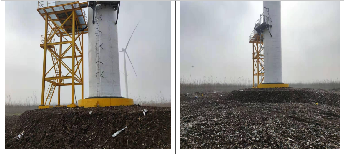
图 2.1-5 箱变基础钢结构平台示意照片(柴下洲风电场)
