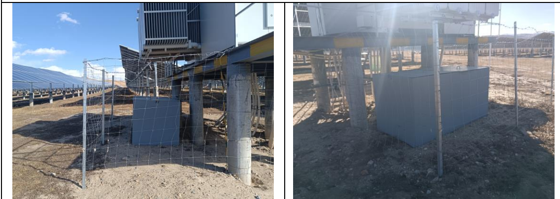
箱变下事故油池（地面长方体铁箱）
